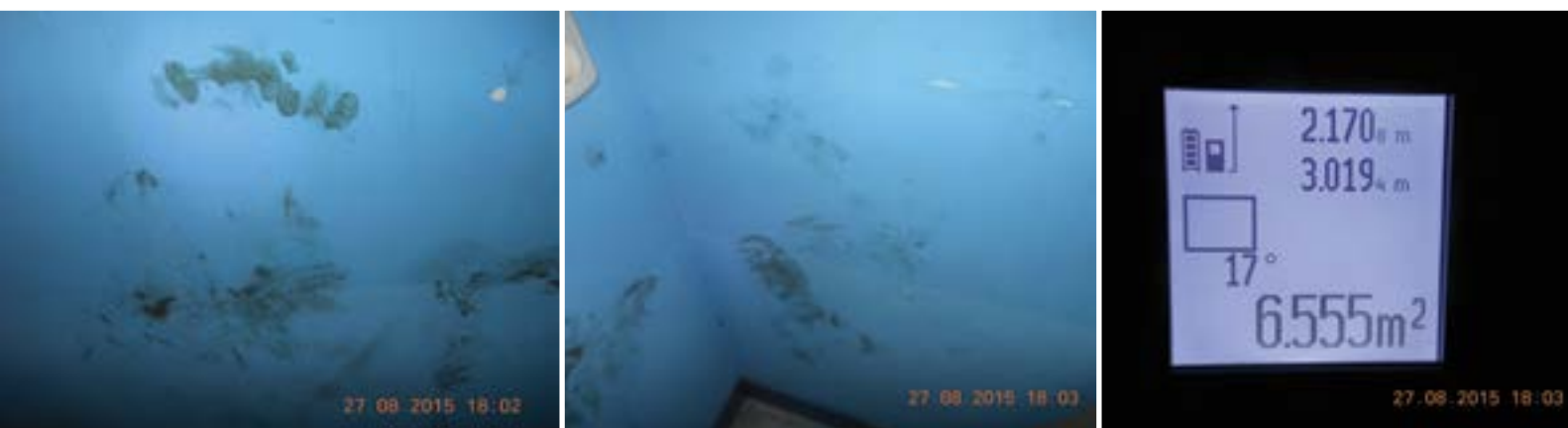
Фото 45-47. Условия содержания и следы крови на стенах в подвальном помещении, которое использовалось как незаконное место лишения свободы пророссийскими вооруженными формированиями. Частный дом, г. Славянск, ул. Розы Люксембург, 53.
